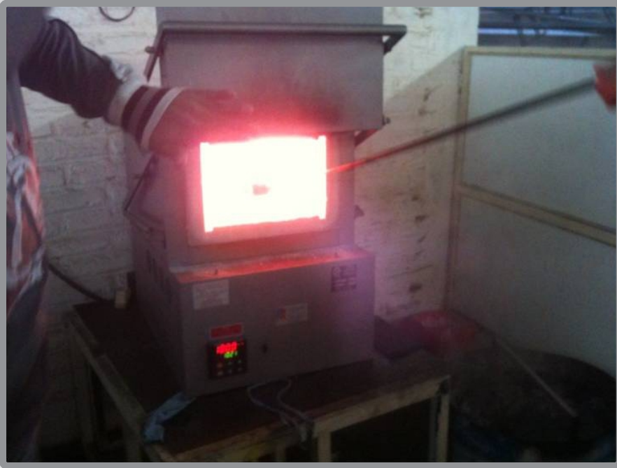
Línea de tratamiento térmico
